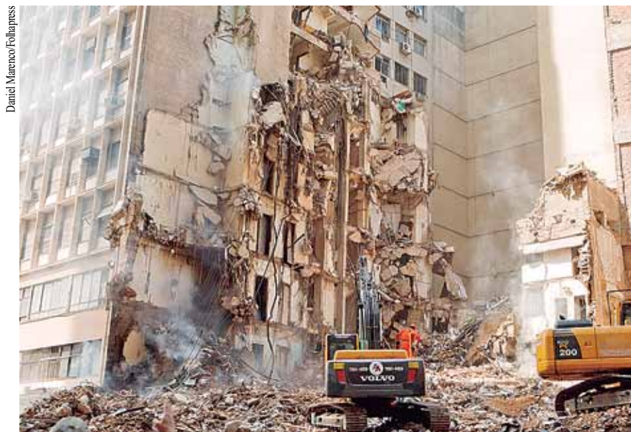
Em 2012, três prédios desabaram no Centro do Rio de Janeiro devido a reforma inadequada, matando mais de 20 pessoas.
